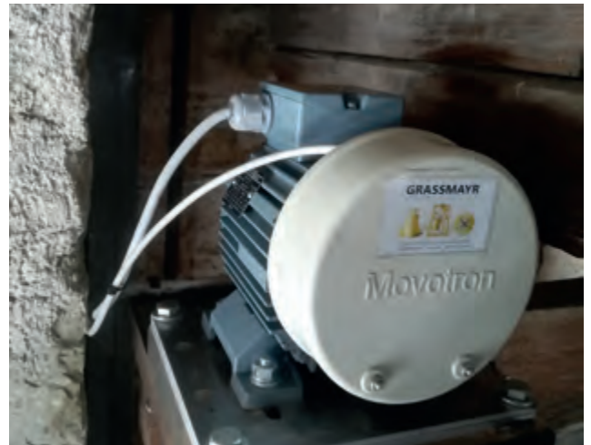
Für den Pfarrkirchenrat bedeutete die Erneuerung der Läute- und Schaltanlage im Kirchturm eine vordringliche Aufgabe. Das Bild zeigt einen der neuen Glockenmotoren, die von der Fa. Graßmayer in Innsbruck montiert wurden. Siehe Bericht Seite 23. Foto: Cornelius Mierer
