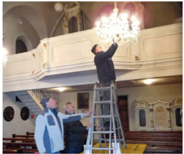
Zum Weihnachtsfest müssen alle Lichter auf den Lustern im hellsten Glanz erstrahlen. Die tüchtigen Helfer erneuern die Lampen in schwindliger Höhe.
